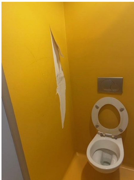
Foto 2: voorbeeld van een toilet met niet-intacte muren
