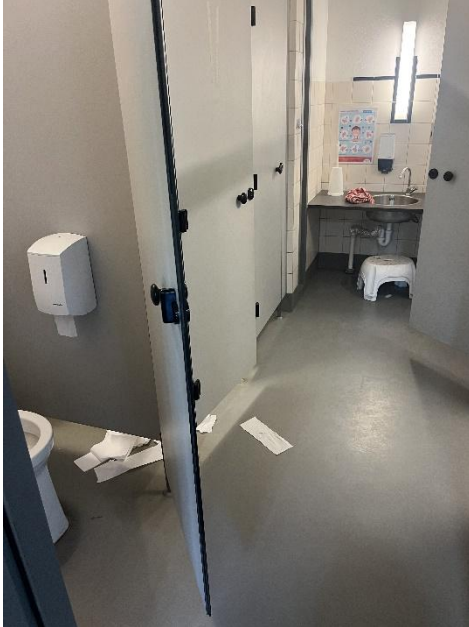
Foto 1: Voorbeeld van een vervuilde algemene toiletruimte
